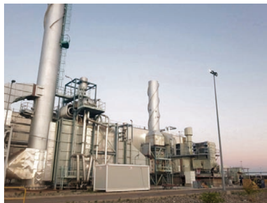
Pohled na energetický celek
