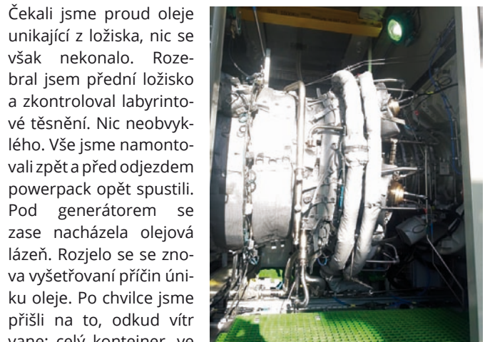
Plynová turbína uvnitř kontejneru
